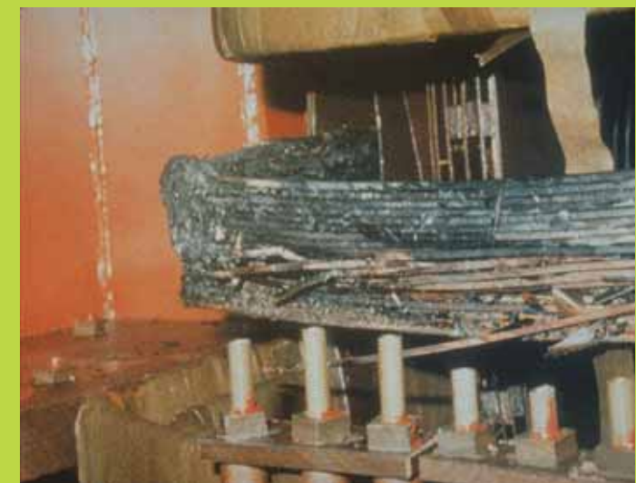
Καταστροφή μετασχηματιστή από μαγνητική καταιγίδα λόγω υπερθέρμανσης
